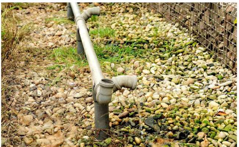
Kontinuierliche Zuführung des Wassers nach der ersten Reinigungsstufe in den Horizontalbodenfilter.
