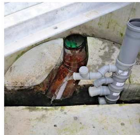
Auslauf des gereinigten Oberflächenwassers im Kontrollschacht nach dem Horizontalbodenfilter der Pflanzenkläranlage.
