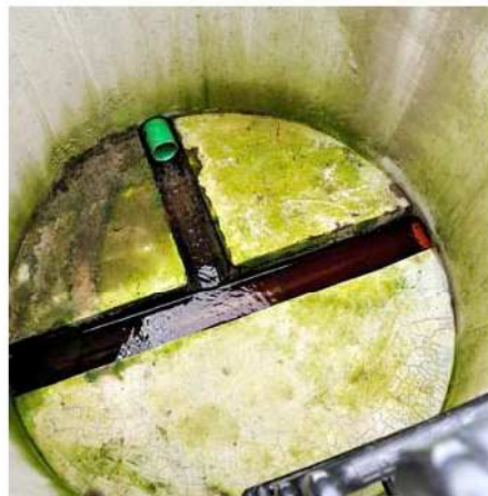
Über den Dreiwegschacht wird dem im Vertikalfilter vorgeklärten Wasser auf dem Wege zum Horizontalfilter zur Erhöhung der biologischen Aktivität eine geringe Menge Rohwasser zugemischt.
