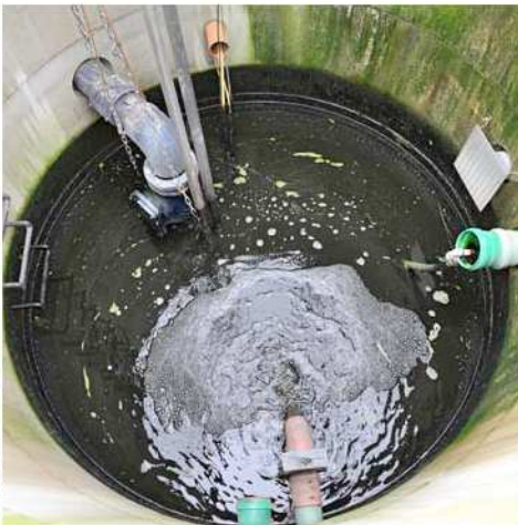
Vom Beschickungsschacht am Pufferteich befördert eine Pumpe das Rohwasser in Intervallen zur Verteilung auf den Vertikalfilter.
